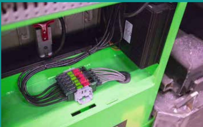
Zur bidirektionalen Steuerung sind für jede Fahrtrichtung drei Lichtleiter mit angeschlossenen Basisgeräten verbaut.
