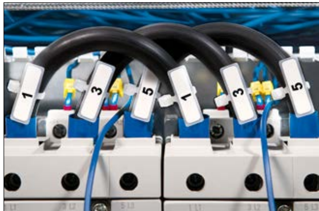
IT Kabelbinder – ein Arbeitsgang mit doppeltem Nutzen.
